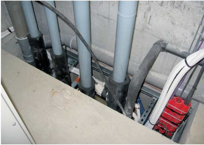
Bild 4. Nicht verschlossener Installationsschacht in der Gebäudehülle
