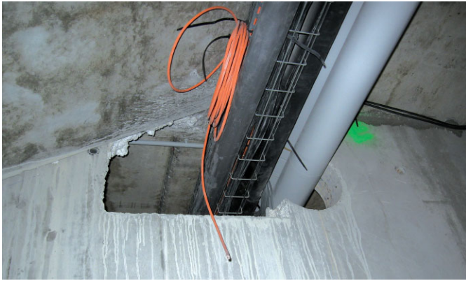
Bild 2. Interne Leckage – Kabeldurchführung in den benachbarten Gebäudeteil
